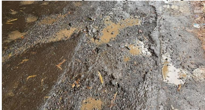
Gambar 3. Kondisi Jalan Merbabu Sebelum Preservasi Tahun 2025 (Sumber: Dokumentasi Penelitian, 2025)
