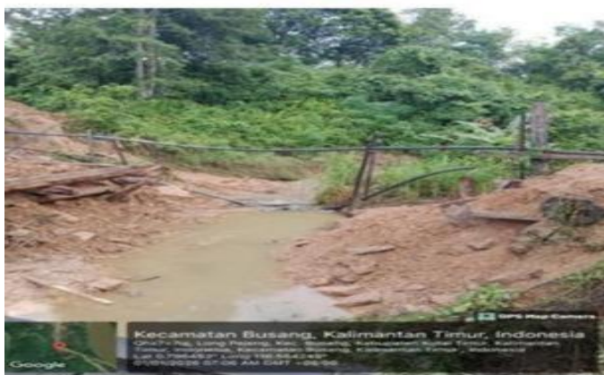
Gambar 2. Kerusakan Jembatan Akibat Erosi dan Lemahnya Konstruksi di Desa Long Pejeng (Dokumentasi Penelitian, 2026)
