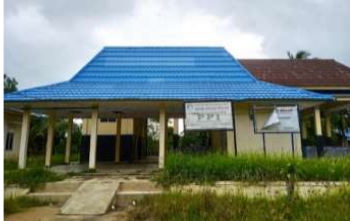
Gambar 2. Kondisi Bangunan Tempat Pelelangan Ikan Desa Pondok Kelapa (Sumber: Dokumentasi Peneliti, 2024)
